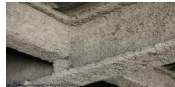
Flocage en amiante
